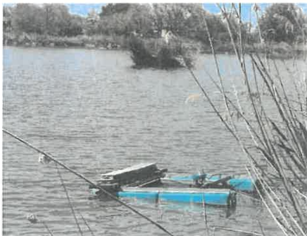
1. ábra: A levegőztető berendezés beszerelve a Ligeti-tavon.
